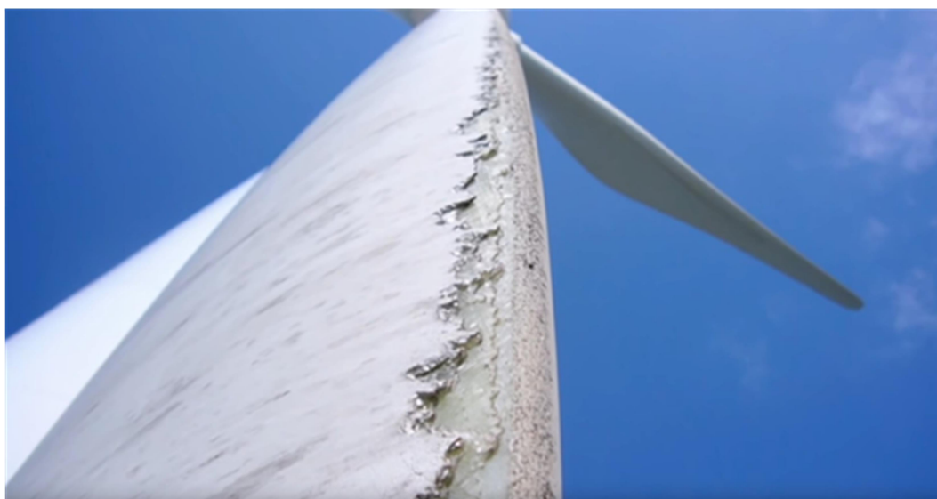
Figur B2 "Leading edge erosion" är ett stort problem för vindkraft. Det leder till stora underhållskostnader och stora miljörisker.
